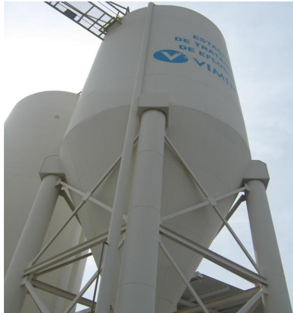
Figura 2.5 - Filtro de decantação de resíduos e o transbordo da água limpa
