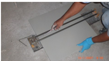
Figur 4.65 – Corte da placa sobre o contrapiso. Ausência de bancada de apoio.
