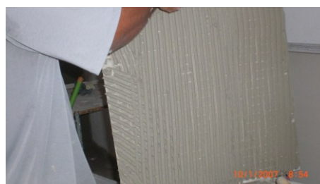
Figura 4.56 – Placa com argamassa penteada
