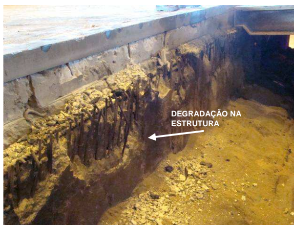
Figura 3.5. Canal secundário de escória – alto forno 3
