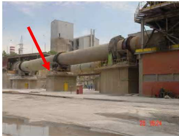
Figura 3.15. Forno rotativo para produção de cal (indicação da base de concreto)
