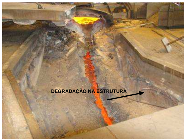
Figura 3.4. Canal secundário de escória – alto forno 3
