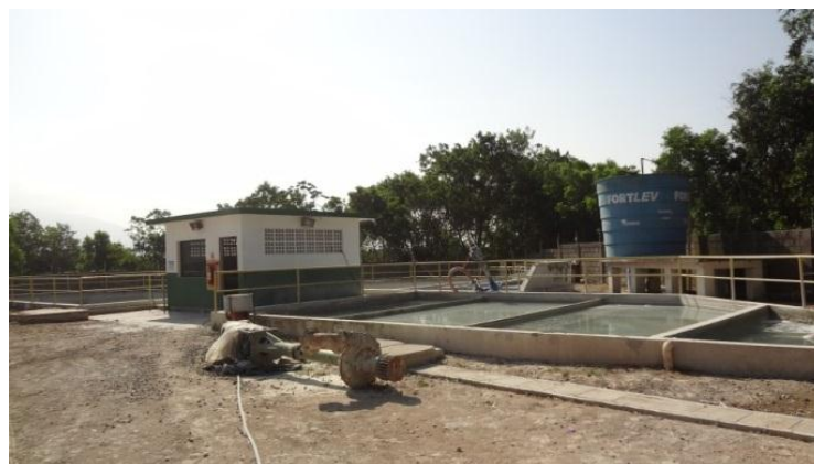
Figura 5 - Tanques de Sedimentação
