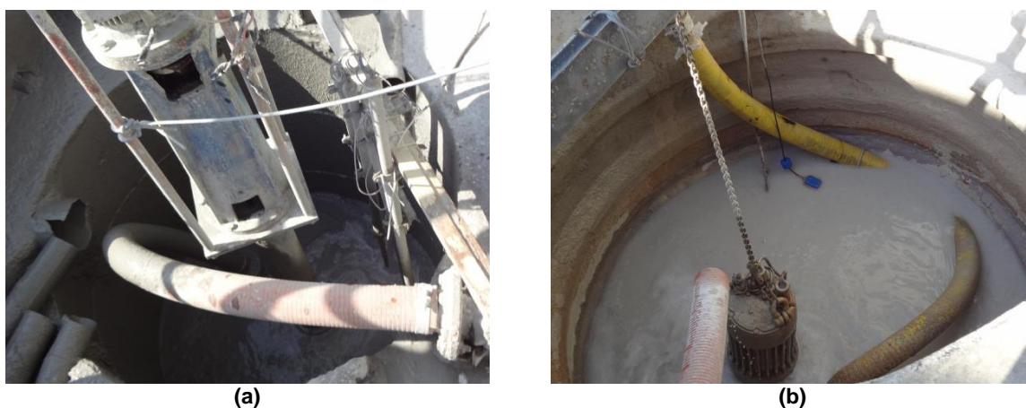
Figura 13: Poço de coleta e destinação de (a) LBRO G e (b) LBRO D para os tanques de decantação.
